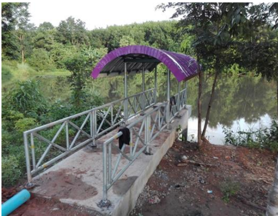
แพสูบน้ำและท่อส่งน้ำจากลำห้วยโสภะชัน
