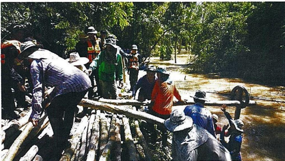
ซ่อมพนัง : ทหาร จากมณฑลทหารบกที่ 39 ค่ายสมเด็จพระนเรศวรมหาราช และกองพันทหารอากาศโยธิน กองบิน 46 พิษณุโลก ร่วมกันซ่อมพนังกันน้ำที่เสียหาย จนน้ำทะลักท่วมบ้านเรือนประชาชนและพื้นที่เกษตร ใน อ.บางกระทุ่ม
