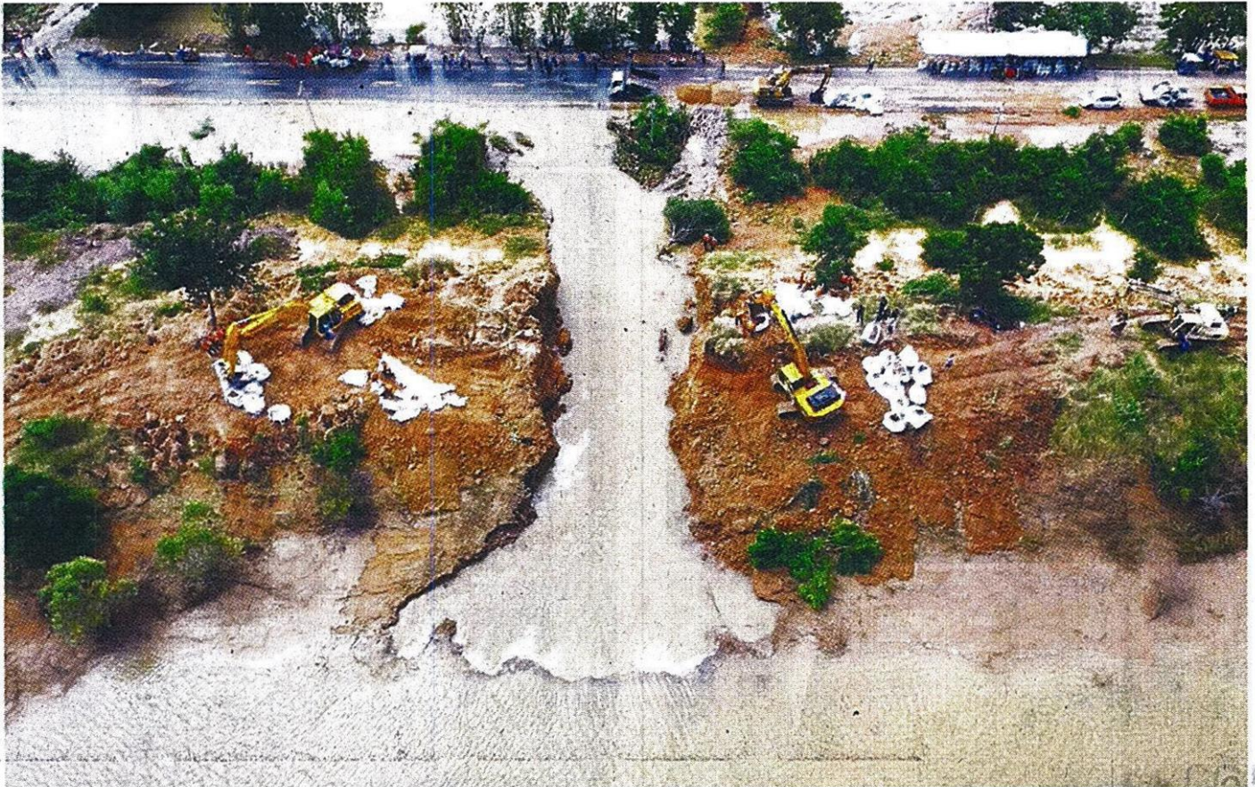
ขอมสร: กรมชลประทานนำรถแบ็คโฮพร้อมเครื่องมือ เร่งซ่อมแซมสระเก็บน้ำ ขนาด 700,000 ลูกบาศก์เมตร ในมหาวิทยาลัยเกษตรศาสตร์ วิทยาเขตลพบุรี หลังผนังสระแตก น้ำกว่า 600,000 ลบ.ม. ไหลทะลักเข้าท่วมทุ่งนา สร้างความแตกตื่นให้กับประชาชน วานนี้( 18 ต.ค.)
