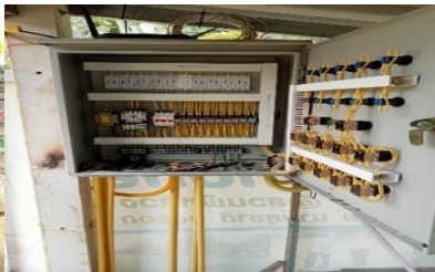
แผงควบคุมระบบให้น้ำ
